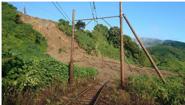
大井川鐵道の被災状況
